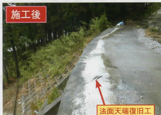
法面に滑りが発生し、法面上部に隙間が空いた。
