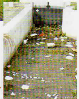
ゴミによる 水門閉塞状況
